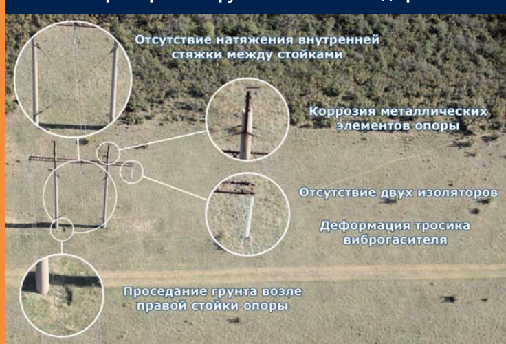
Рис. Примеры обнаруживаемых на ВЛ дефектов
