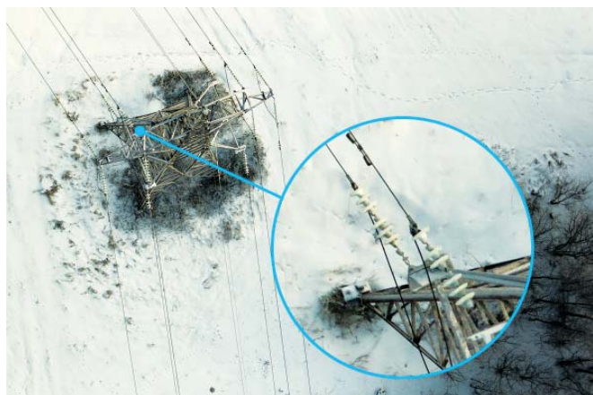
Рис. 1. Выявление повреждения изоляторов
