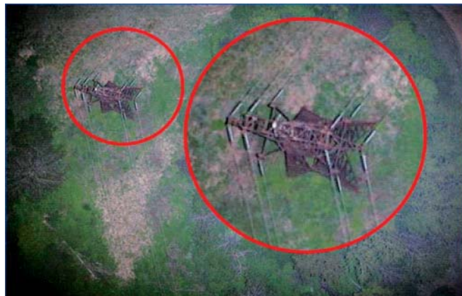
Рис. 6. Тестовая съёмка ВЛ в ночное время с помощью фотовспышки в целях отработки поиска мест аварии. Высота 120 м, время съёмки 00.35, 2010 г.
